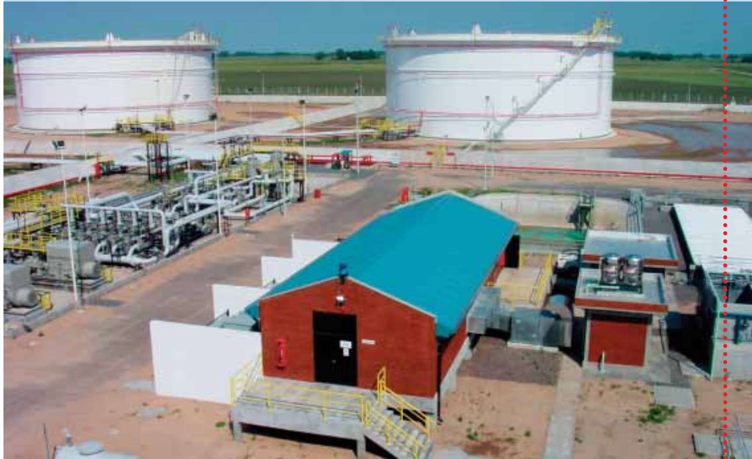
Las nuevas instalaciones incluyen un terminal de almacenamiento con una capacidad total de 60,000 m 3 , una estación de bombeo completa con una capacidad de 20,000 m 3 /día y un oleoducto de 20" de diámetro y 167 km de largo que une la nueva terminal con la refinería de Esso en Campana.
