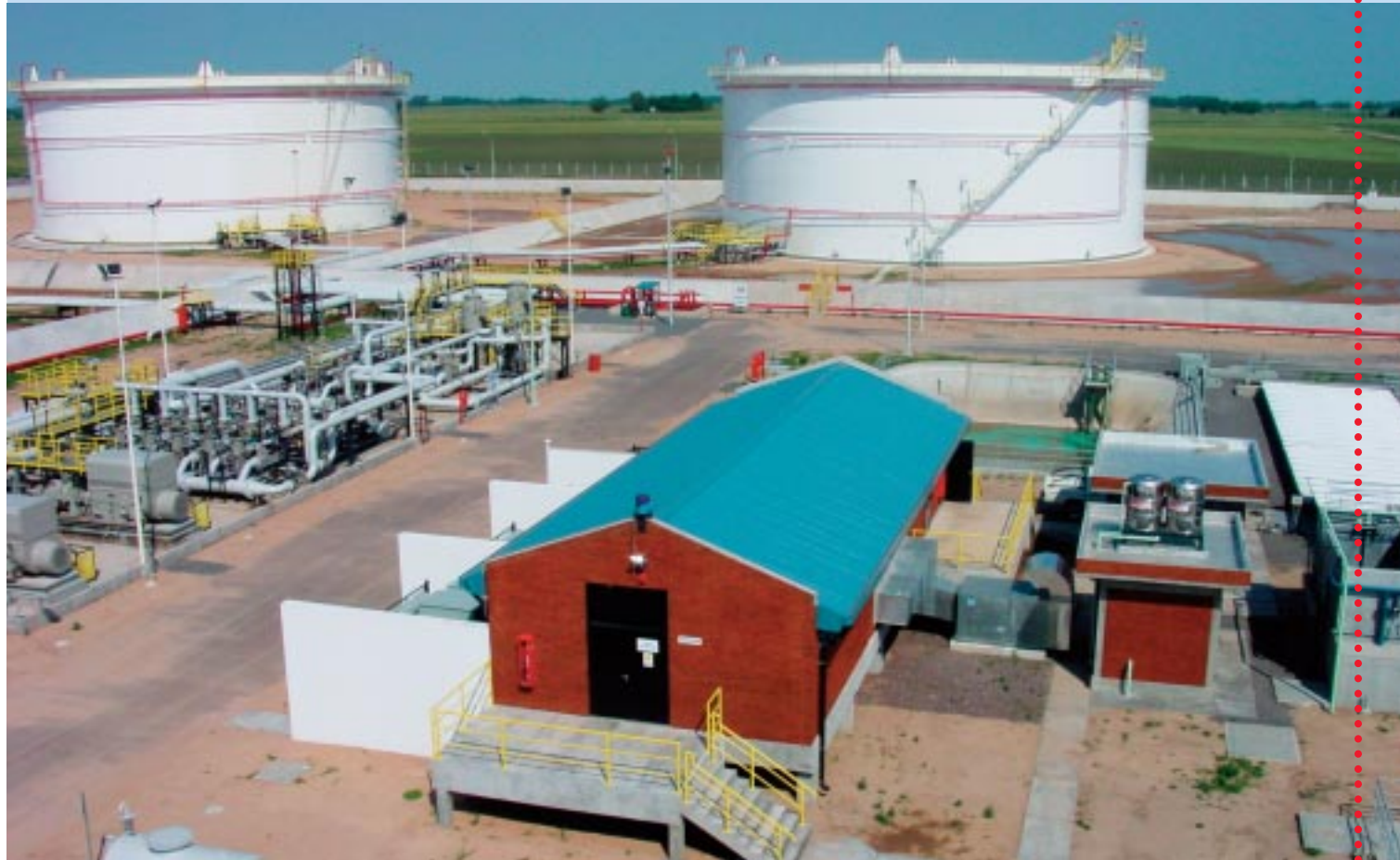
Die neue Anlage beinhaltet ein neues Tanklager mit einer Gesamtkapazität von 60.000 cbm, einer kompletten Pumpstation mit einer Kapazität von bis zu 20.000 cbm/Tag und einer 167 km langen Pipeline mit einem Durchmesser von 560 mm, die das neue Tanklager mit der Esso-Raffinerie in Campana verbindet.
