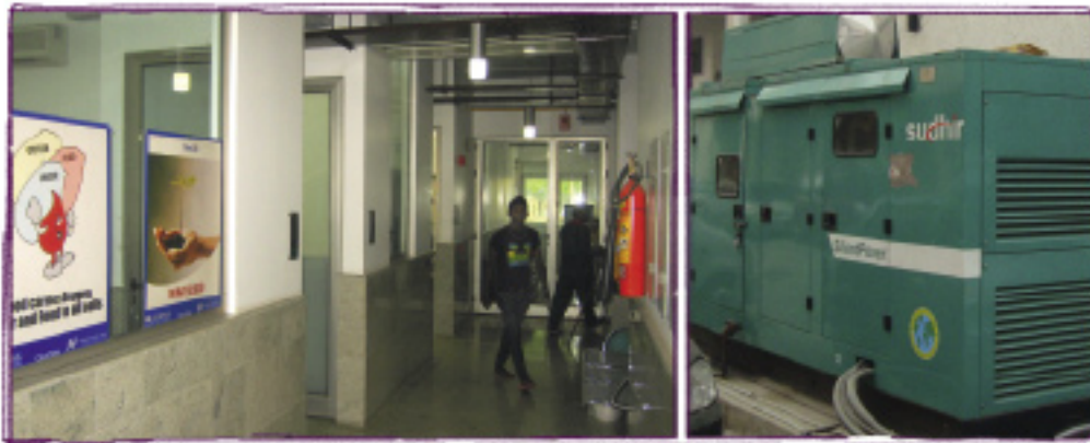
Ein 320-kVA-Generator sichert nun in einem Blutbankprojekt in Neu-Delhi die Kühlung von Blutkonserven im Falle von Stromausfällen.
